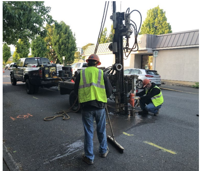
Equipo de construcción que realiza trabajo de campo en el área del proyecto. Al igual que con el trabajo de campo, la construcción utilizará herramientas tales como escobillas para capturar y eliminar la tierra y los desperdicios sueltos producto de las actividades de construcción, las máquinas y los vehículos durante el trabajo y después de este.
